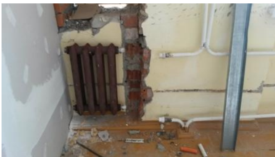
Раздел 7. Электроосвещение: демонтаж светильников, скрытой проводки, прокладка кабелей, установка розеток и светильников
